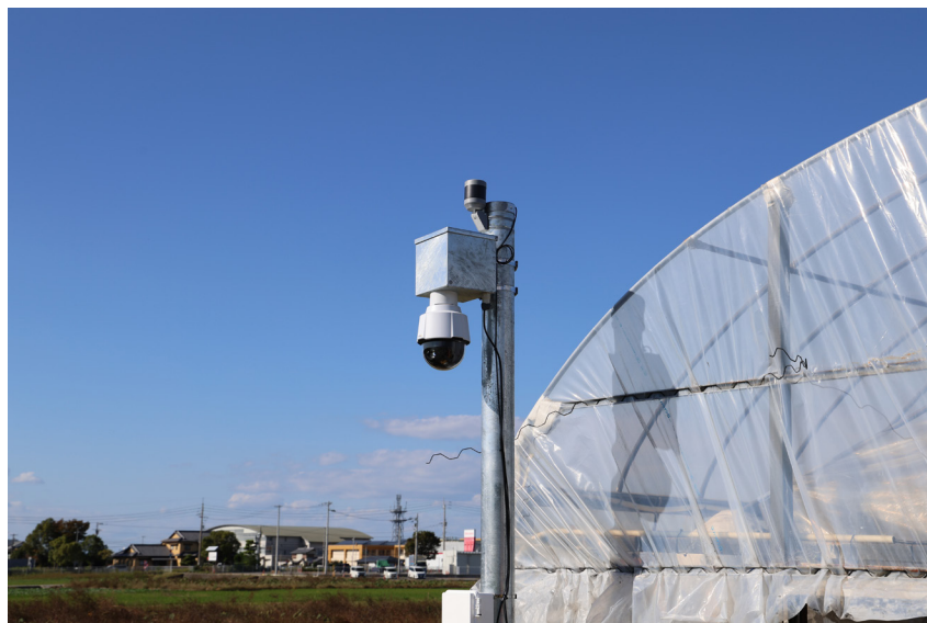
農地に設置されたネットワークカメラ
